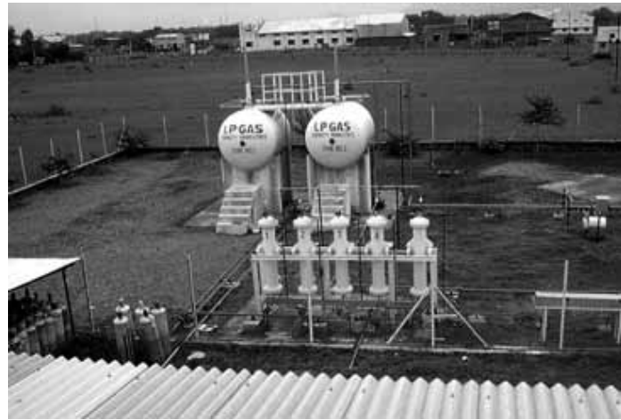
Un parc de réservoirs de taille réduite bien conçu en Inde.
