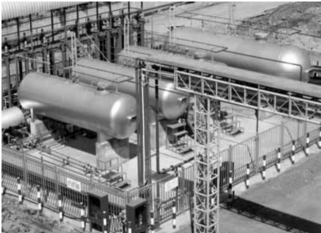
Les conduites d'agent propulseur en tranchées sont mieux mais plus coûteuses.
