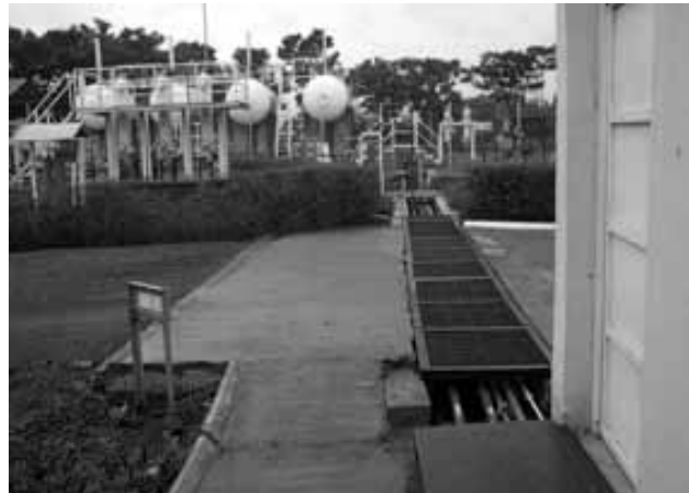
On peut voir dans cette excellente installation en Thaïlande des piliers de protection, de bonnes barrières et un système de déchargement en parallèle. Remarquez aussi la hauteur du « pont de conduite ».
