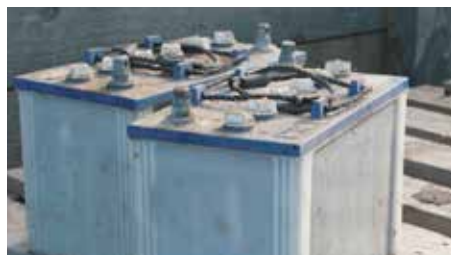
Fig. 46: Exemple de la gestion des batteries au plomb usagées incorrecte
