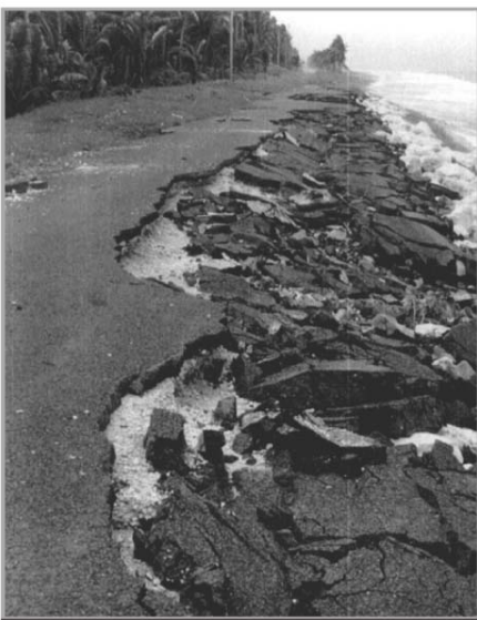
Figura 5. La destrucción de la infraestructura adyacente a la costa, es otro de los problemas que se manifiestan con el ascenso del nivel medio del mar. (Barra de Tupilco, Tabasco).
