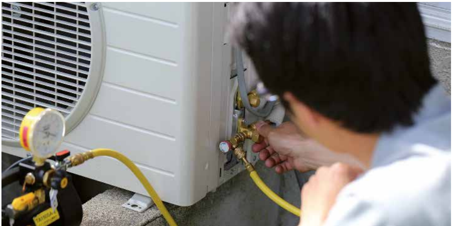
Figure 6 : Changement de fluide frigorigène dans un appareil de climatisation
