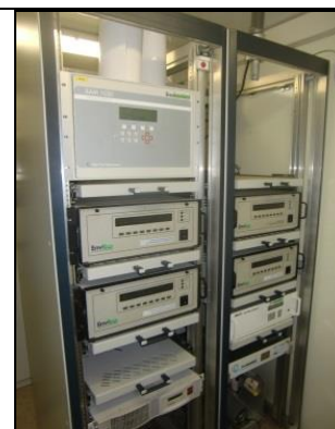
Image 2 : Analyseurs d'air ambiant installés à l'intérieur des stations
