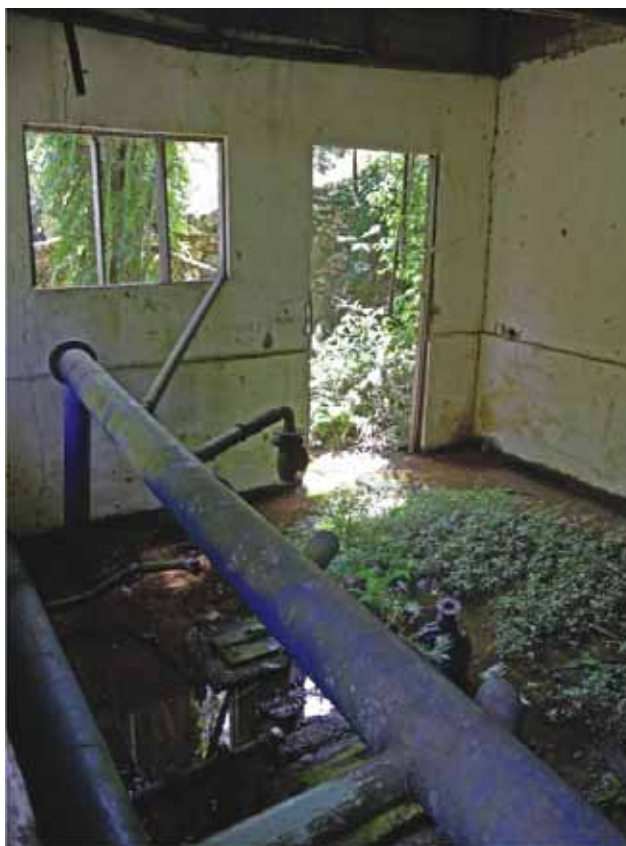
Pendant le conflit, de nombreux centres de la REGIDESO, tels que celui de Ndjongobono à Lisala (province de l'Equateur), ont été pillés
