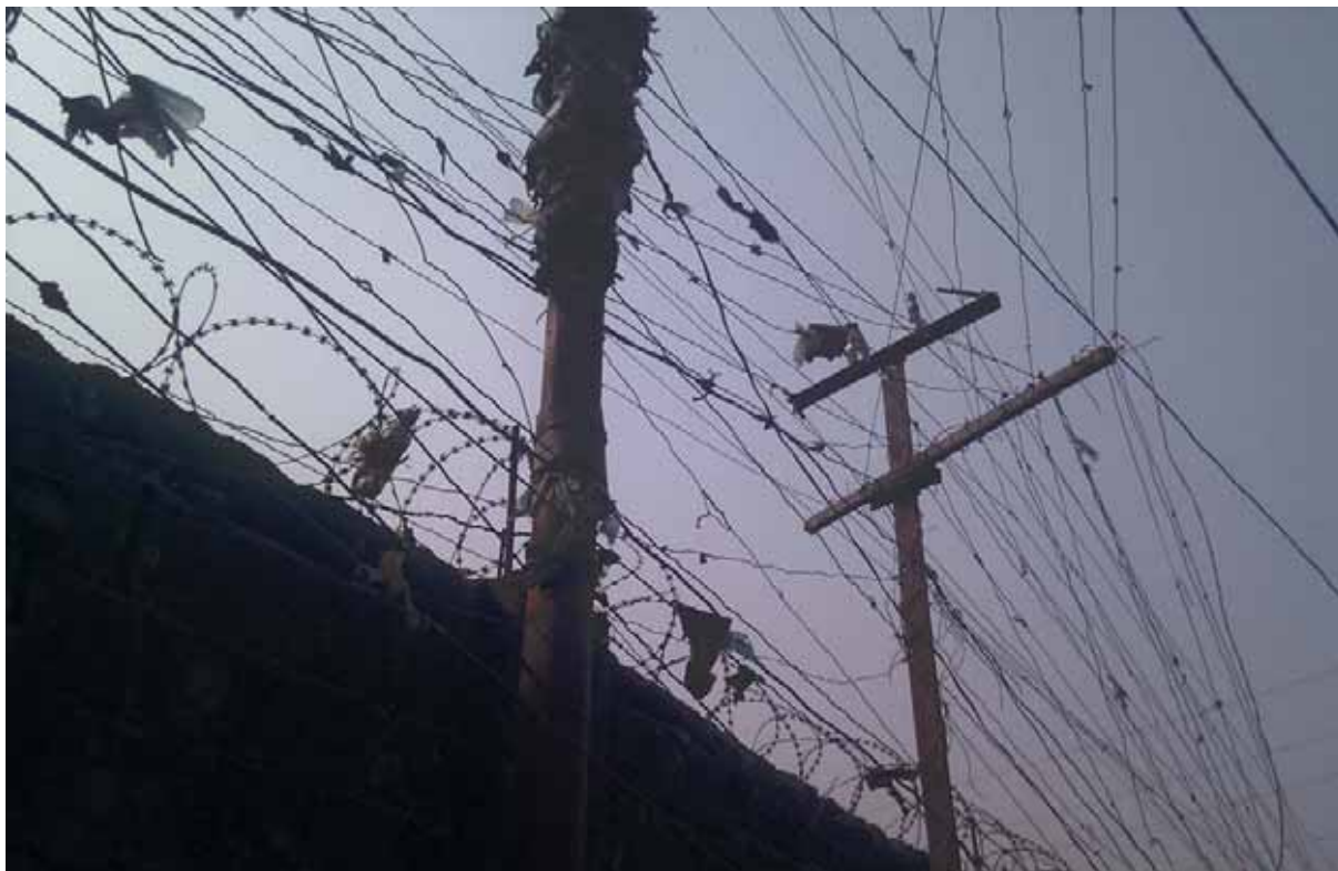
Les ménages souffrent d'un manque d'accès au réseau électrique ce qui se traduit par des raccordements ingénieux mais dangereux
