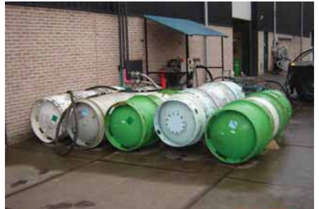
Photo 6-20 – Bouteilles pressurisée d'une capacité d'une tonne (1000 kg)
