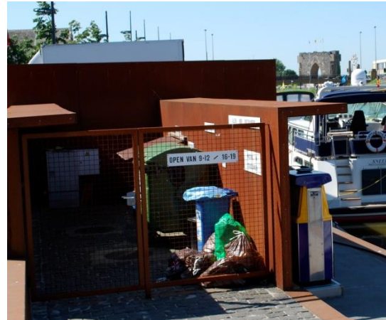
Installation de réception combinée pour les eaux de cale et les ordures dans une marina en Belgique (Crédits photographiques : Peter Van den Dries)
