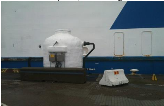
Recogida de aguas residuales en el puerto de Trelleborg (Suecia) (Foto: Clean Baltic)
