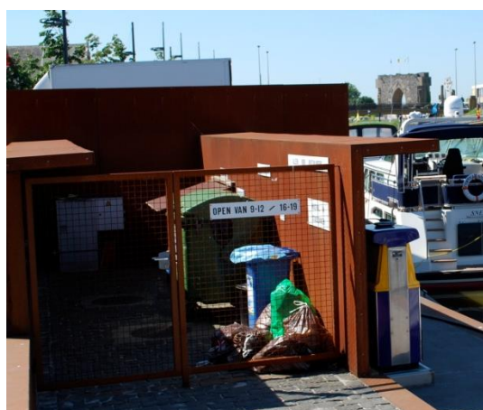
Instalación combinada de recepción de agua de sentina y basura en un puerto deportivo en Bélgica
