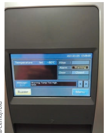
Fig. n°4 : Armoire de stockage de vaccins à -75^{\circ}\text{C} à l'hôpital et son panneau de contrôle
