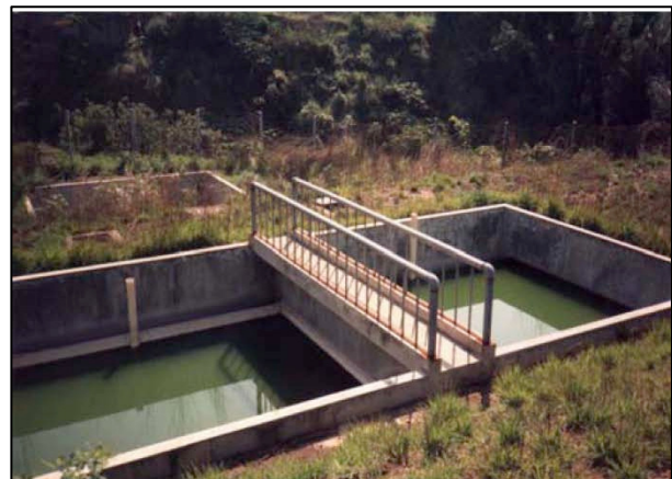
Caudales canalizados a tanque de contacto con cloro para su desinfección y luego descargados al río.
