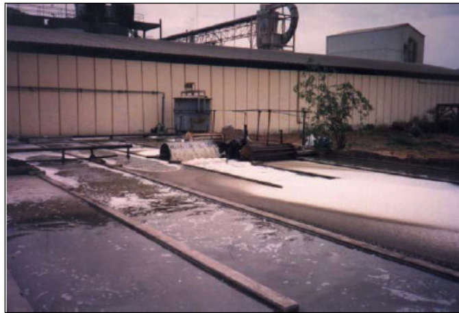
Fosa de oxidación en una planta de pretratamiento industrial para tratar glucosa. La espuma proviene de problemas hidráulicos en el diseño original. La planta es operada y mantenida inadecuadamente, resultando en problemas de estabilidad de fangos.
