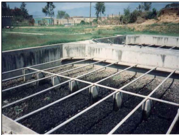
Filtro percolador de alimentación estática con un medio barato de roca volcánica Aguas residuales esparcidas por medio de tubos baratos de PVC perforados.
