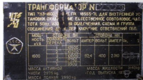
Placa de identificare a transformatorului cu conținut de BPC de tip ТНЗ-1600/10 cu 3140 kg de sovtole, uzina Circic
