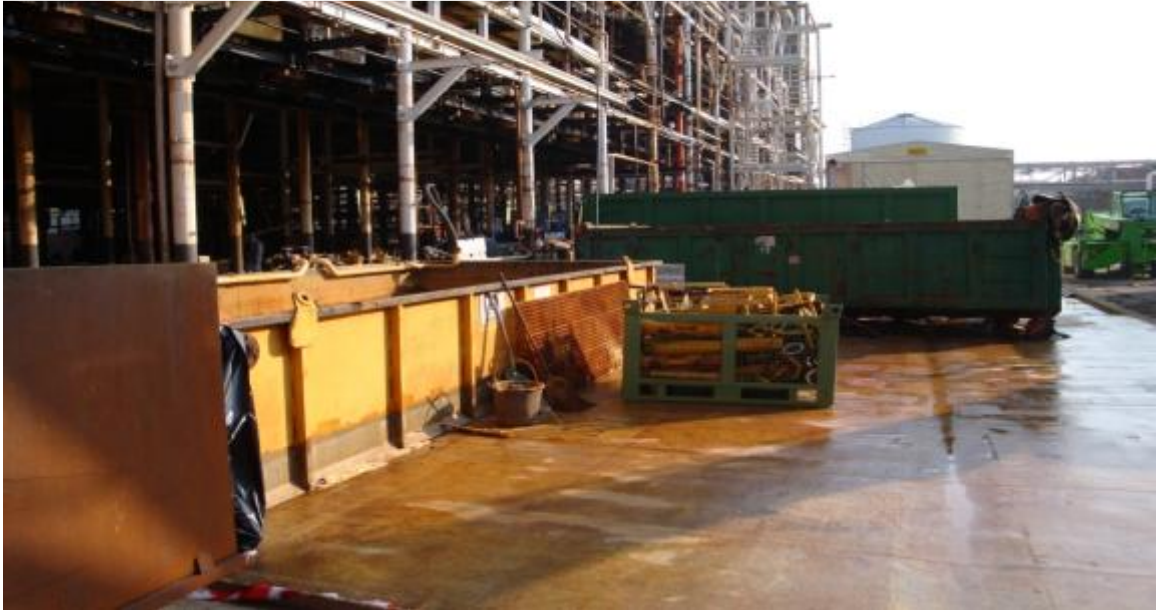
Zona de trabajo para la manipulación segura de equipos contaminados conectados a la unidad de tratamiento de efluentes con mercurio, lavados periódicamente con agua
