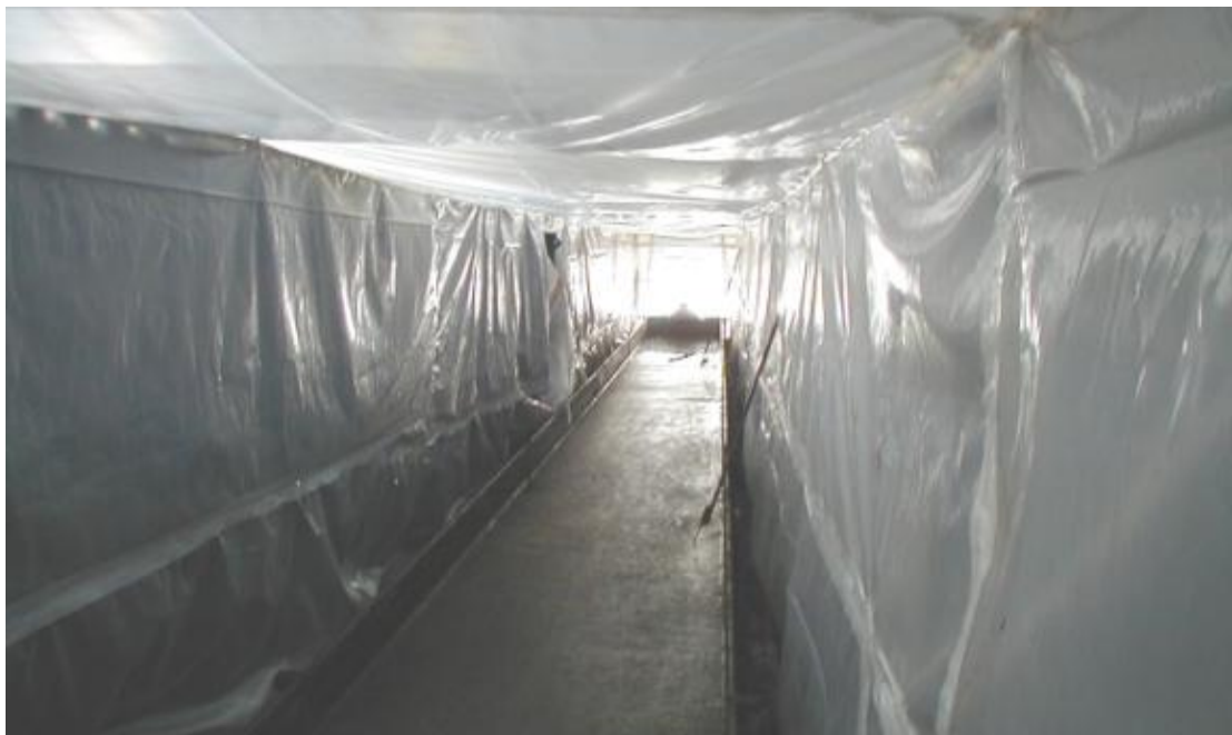
Confinamiento de las celdas (conectadas a la unidad de tratamiento del aire)
