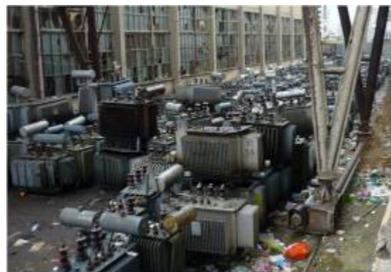
Photo 8: Transformateurs contenant des huiles contaminées aux PCB dans les entreprises d'électricité inspectées en 2010
