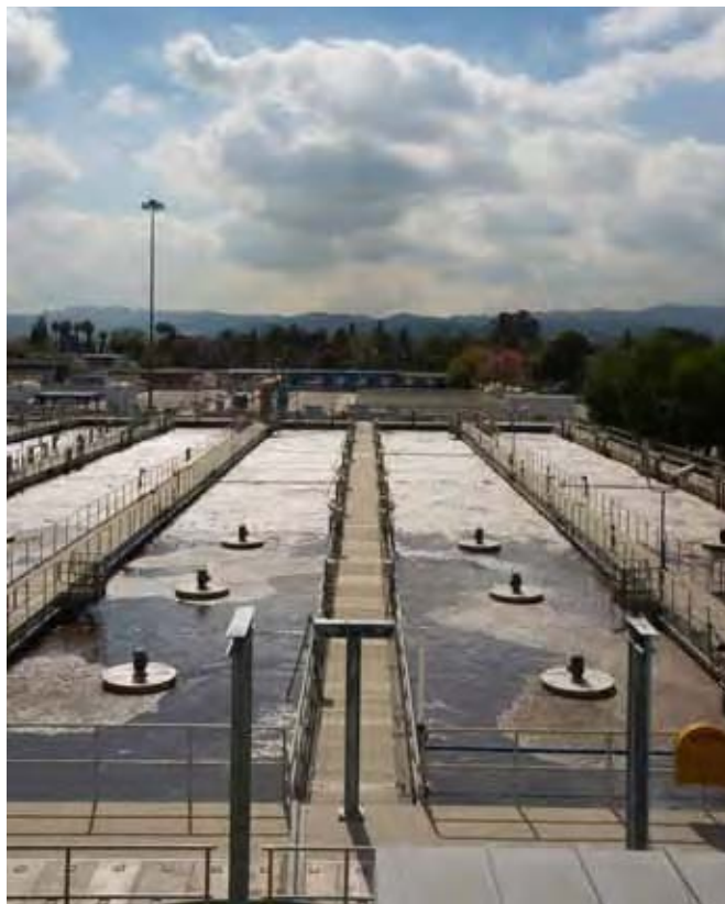
Очистные сооружения, Лос-Анджелес, США. © John Crall/iStock
