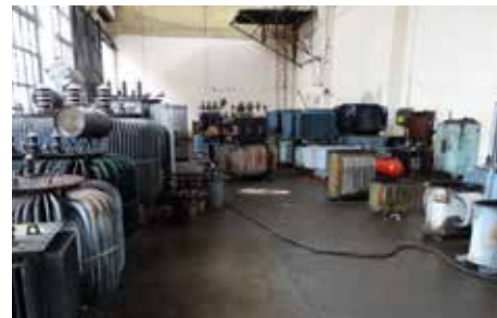
Photo 40 : Transformateur en zone de maintenance
