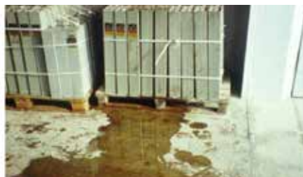
Photo 85: Mauvais exemple II (absence de bac récepteurs)
