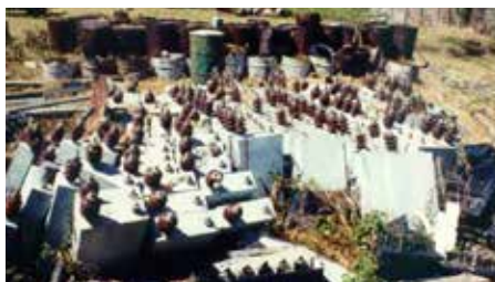
Photo 84 : Mauvais exemple I (entreposage à ciel ouvert)
