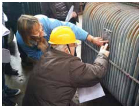
Photo 9 : Enregistrement de toutes les données des appareils électriques échantillonnés
