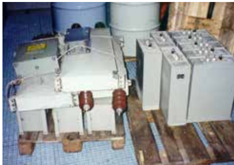
Photo 57 : Exemple de conditionnement et d'entreposage non appropriés
