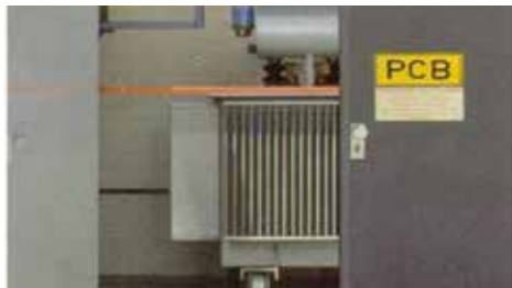
Photo 38 : Étiquetage de la porte d'une salle de transformateurs
