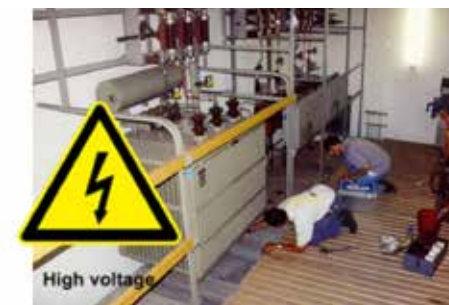
Photo 2 : Prendre en compte également les mesures de sécurité électrique
