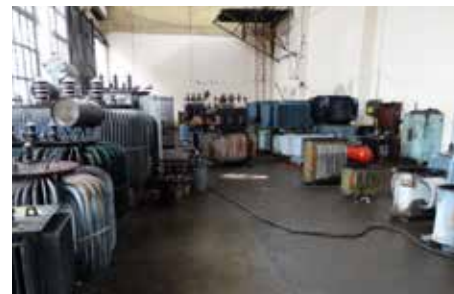
Photo 51 : Incendie proche d'une sous-station
