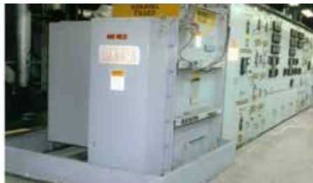
Photo 39 : Système de rétention en acier
