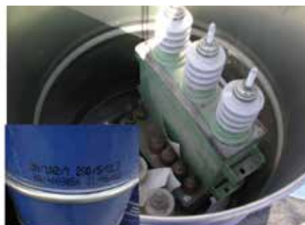
Photo 68 : Condensateurs contenant des PCB dans un fût en acier
