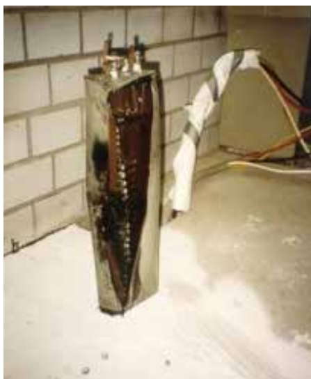
Photo 50 : Condensateur ayant explosé
