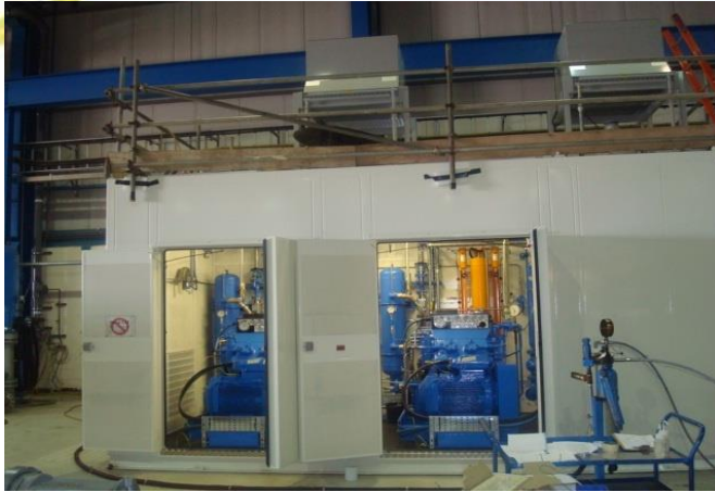
COMPRESSEUR GAZ NATUREL PETROCI
