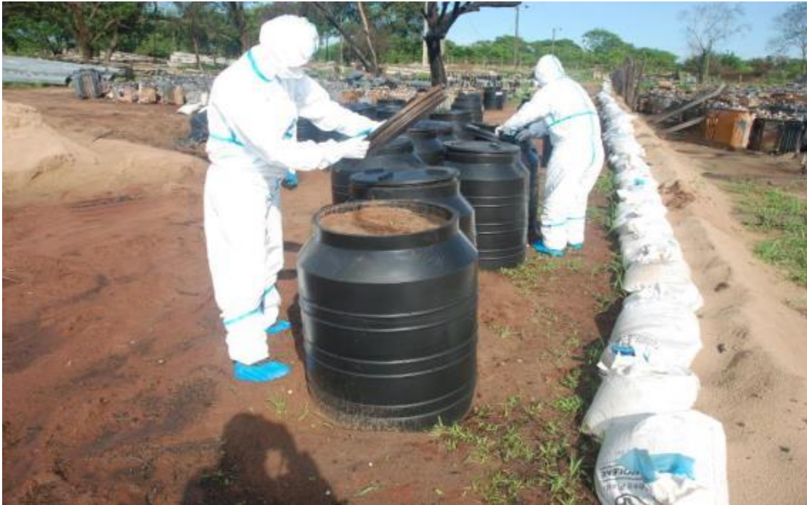
Imagen 11. Tambores con arena y tapas sin rosca / dique de arena.
