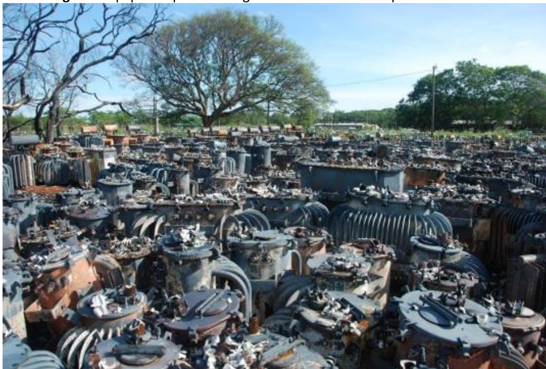
Imagen 7. Equipos dispuestos en grandes extensiones sin previsión de acceso.
