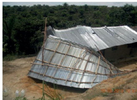
Photo 19. Toit d'une maison emportée par des vents violents au village Selo (partie amont du bassin de la Lukaya)
