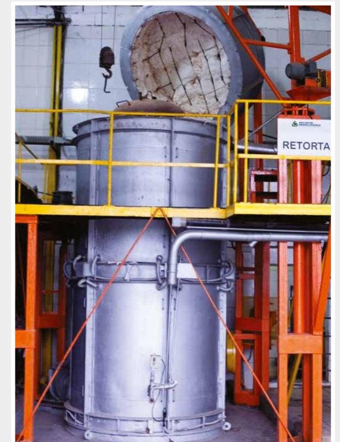
Instalación de Apliquim Brasil Recicle especializada en el tratamiento de lámparas fluorescentes © Apliquim Brasil Recicle
