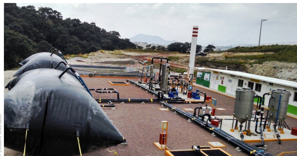
Digestor anaerobio de Atacomulco, México.
