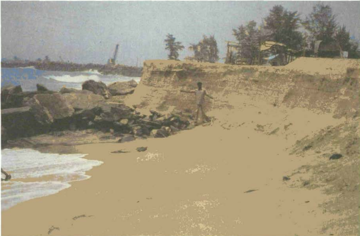
Fig. 1.13. - Erosion côtière catastrophique à Victoria Beach, Lagos (Nigéria) - (Ibé).
