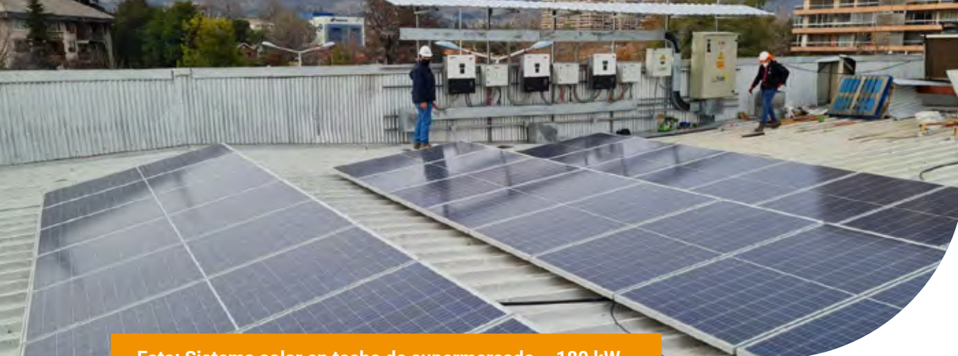
Foto: Sistema solar en techo de supermercado – 180 kW -Comuna Las Condes, Región Metropolitana, Chile.
