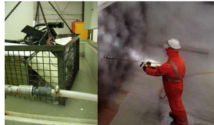
การล้างสิ่งติดตั้งบนโปนด้วยเครื่องฉีดน้ำแรงดันสูงหรือด้วยกาซุ่มในสารเคมี
