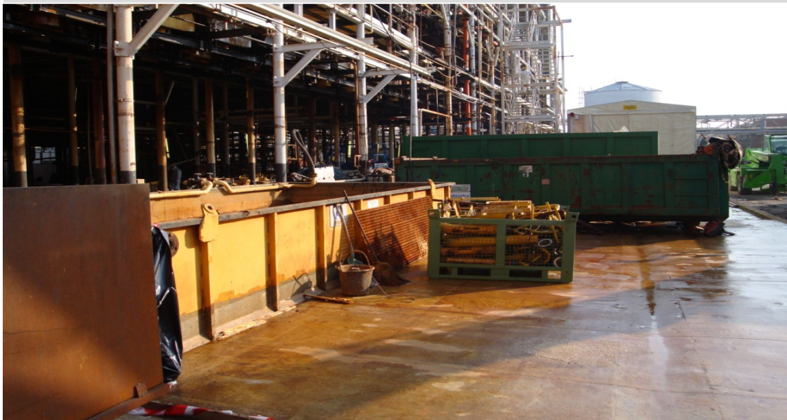
Zone de travail connectée à l'unité de traitement des effluents, régulièrement arrosés avec de l'eau
