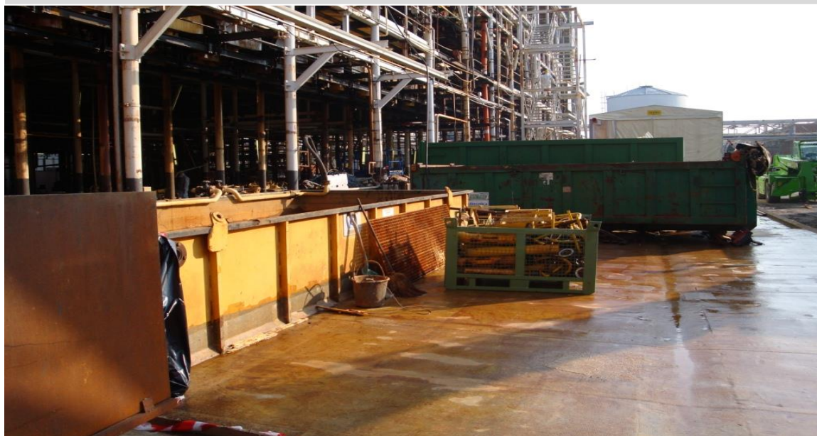
Zone de travail connectée à l'unité de traitement des effluents, régulièrement arrosés avec de l'eau
