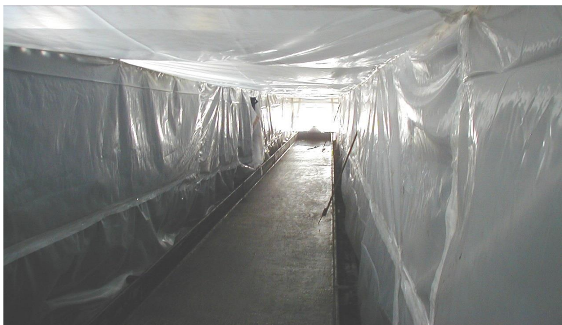
Confinement cellulaire (relié à l'unité de traitement de l'air)
