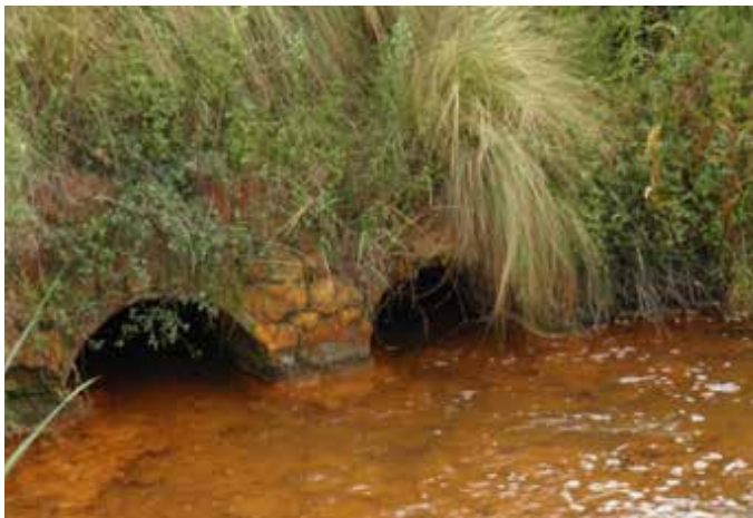
Rejets d'eaux d'exhaure acides de la mine de West Rand, Afrique du Sud Crédit photo : Tamiru Abiye
