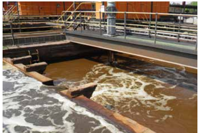
Installation de traitement des eaux d'exhaure, West Rand, Afrique du Sud Crédit photo : Tamiru Abiye
