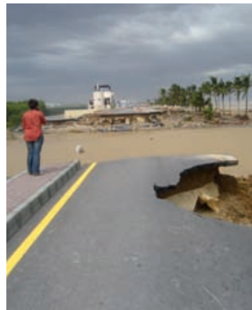
古努气旋(Cyclone Gonu)留下一条残缺不全的公路——洪水淹没街道,电线倒塌,供水设施受损,以及海岸基础设施遭到破坏。来源: Dilip Correa/ Daijiworld.com
