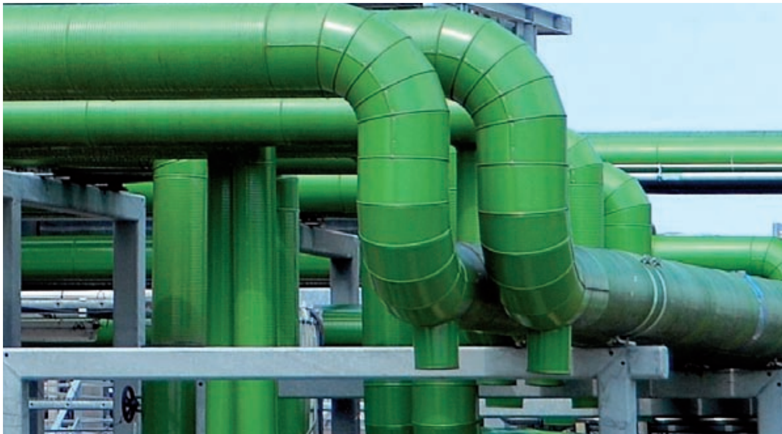
丹麦凯隆堡市产业共生园区（Kalundborg Symbiosis Industrial zone）的一家发电厂蒸汽管道和乙醇浓缩再利用设施
