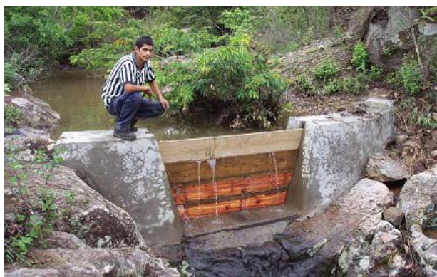
Presa pequeña, Corinto, El Salvador Fotografía: USAID.
