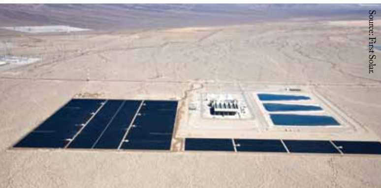
Solar Power Plant, El Dorado, Nevada USA.
