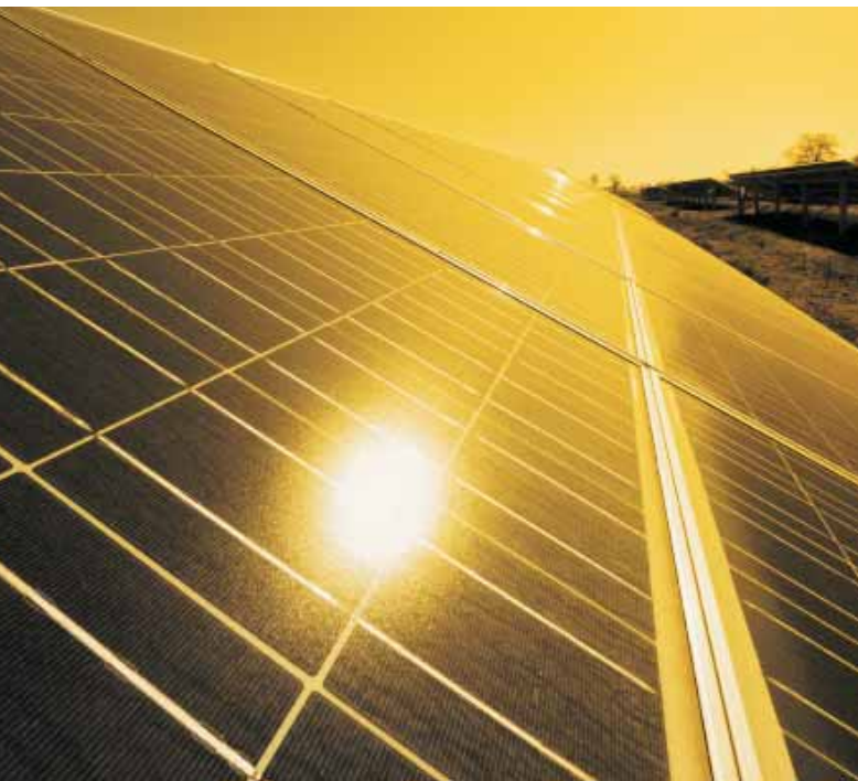
La planta de energía solar con un costo de 600 millones de USD en Abu Dhabi, que se espera se concluya en 2012, será una de las plantas de energía solar concentrada más grandes del mundo. © Fernando Alonso Herrero
