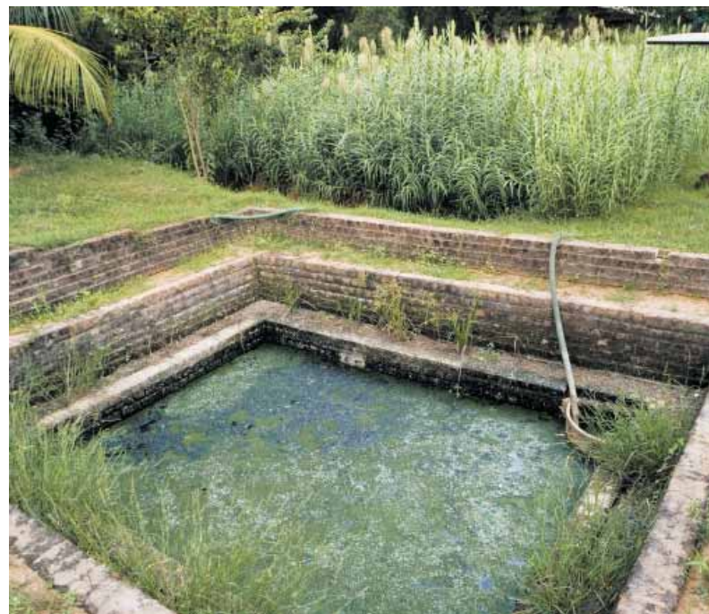
Sistema de tratamiento de aguas residuales descentralizado para volúmenes pequeños en Nadu, India. © Chinch Grymiewicz/SpecialistStock
