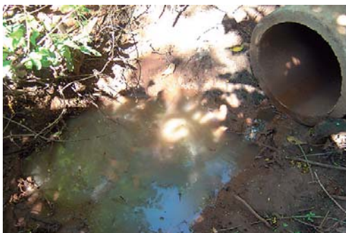
Figura 16 – Esgoto lançado nas nascentes
