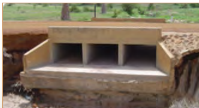
Photo 4 : Menace sur les infrastructures
