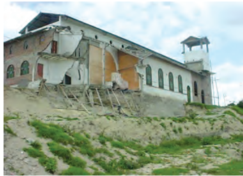
Figura 4.2. Daños a la infraestructura
