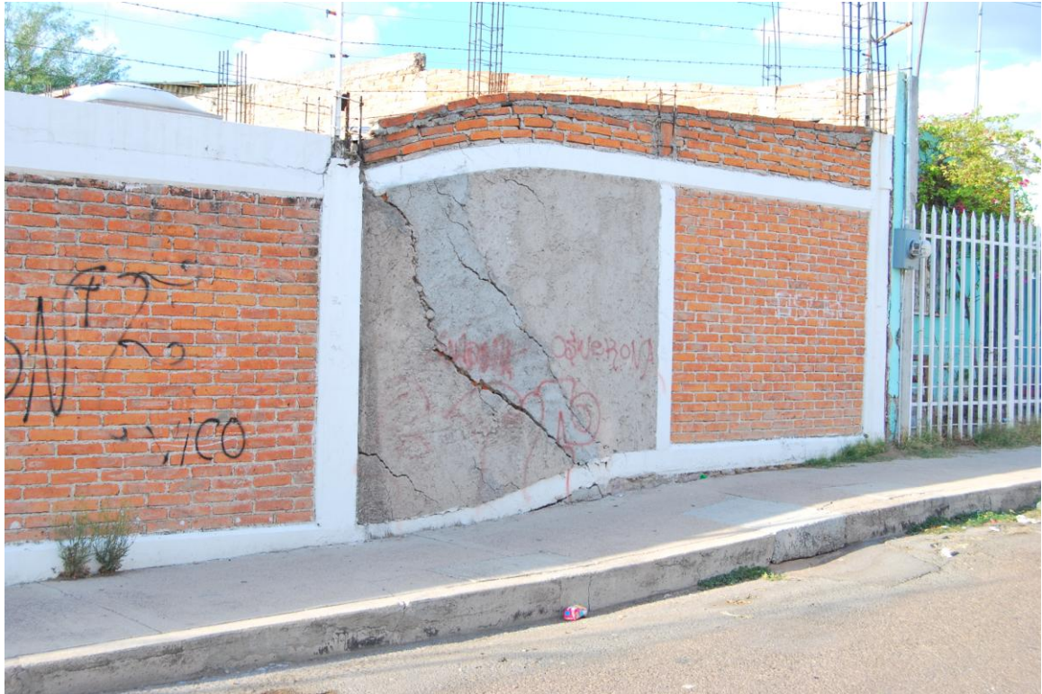
Imagen 7 Daños en Estructuras Habitacionales
