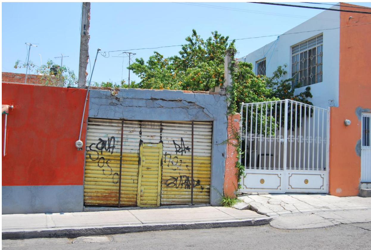
Imagen 8 Daños Casa Habitación/Fallas Geológicas
